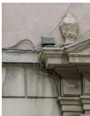
Câbles et réseaux à purger
