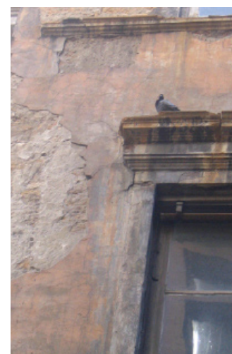
Etat de l'enduit
