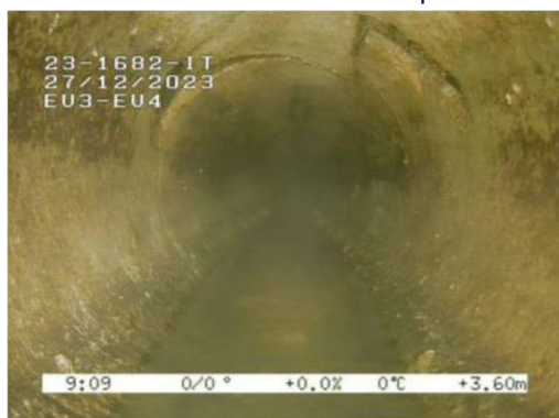
Photo du collecteur avant réhabilitation
